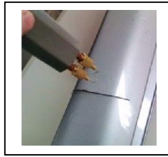
サイトステップ 亀裂部-1
